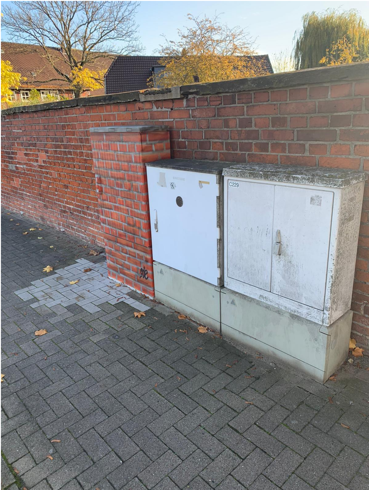
Telekommunikations-Versorgungshäuschen ‚Hinter dem Dorfe‘ (Foto: Maximilian Wahl)
