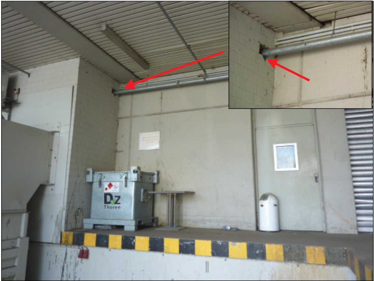
Abb. A-5: Beispiel für bautechnisch bedingte Öffnungen in der Fassade, die Vögeln als Nistplatz oder einzelnen Fledermäusen als Tagverstecke dienen können.
