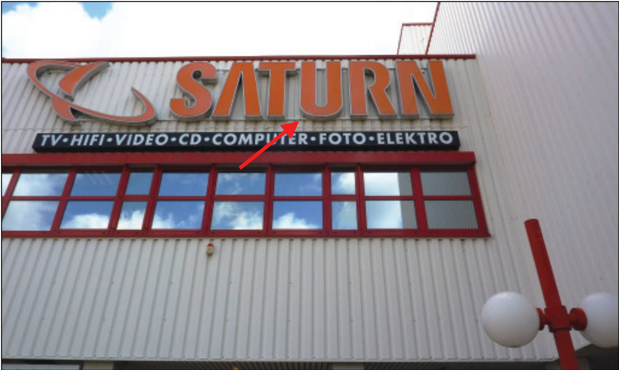
Abb. A-3: Nester des Haussperlings an der Fassade (roter Pfeil).
