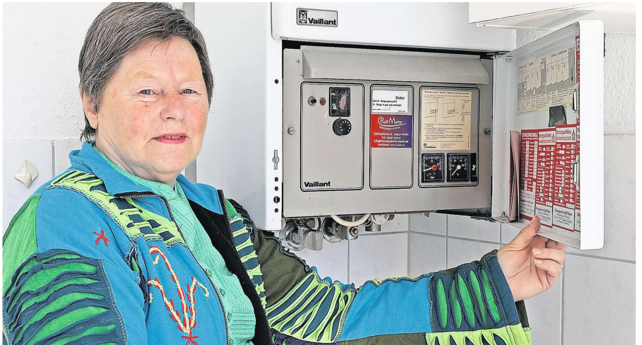
„Komplexität wird nicht mitgedacht“: Hauseigentümerin Evelyn Werner vor einer Kombitherme. Das Gerät produziert Heizungswasser und Warmwasser etwa zum Duschen. Aber es ist nur für eine Wohnung da. Wenn auf ein zentrales Heizsystem umgestellt werden soll, was bei Fernwärme nötig ist, muss das gesamte Haus umgebaut werden.
