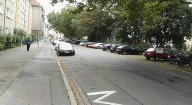
Alter Straßenbelag Ricklinger Straße
