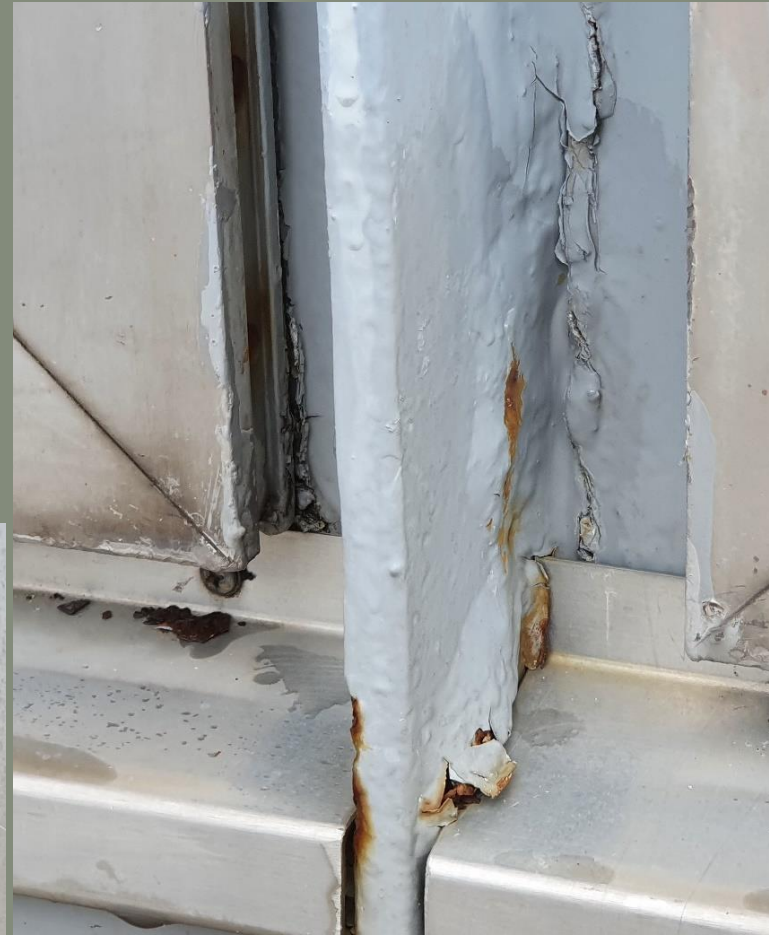
Korrosion der Stahlträger verdeckt unter der Farbe
