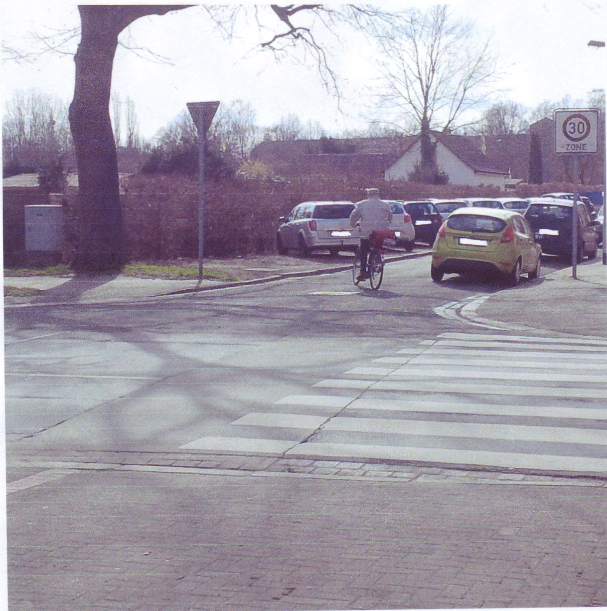
Fehlende Furt an der Einmündung der Juglerstr.
