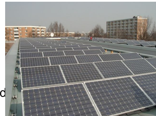
Photovoltaikanlage GY Herschelschule
