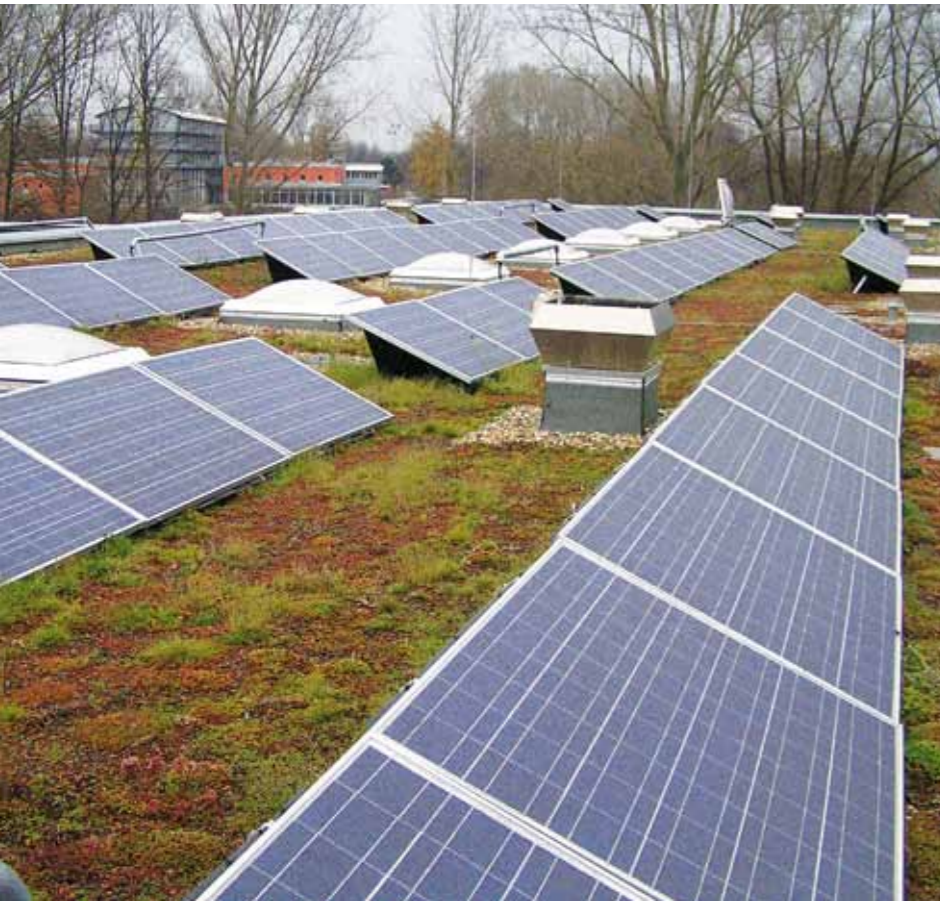
Abb. 19: Auf dem Dach des Werkhofes Stammestraße wurde zusätzlich zur Dachbegrünung eine Photovoltaikanlage installiert.
