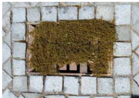
Abb. 16: Eingeschränkte Funktion des Straßeneinlaufes durch Abschwemmungen von Pflanzenmaterial, hier auf dem Tramplatz vor dem Neuen Rathaus. (Foto: FB Umwelt und Stadtgrün, LHH)
