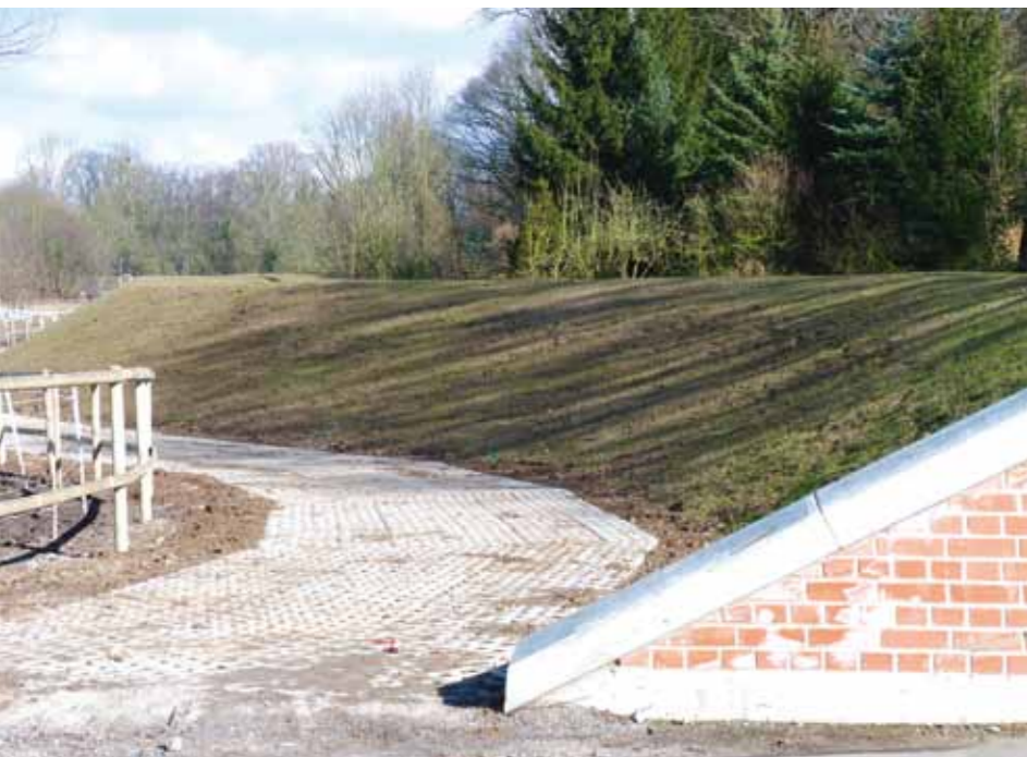
Abb. 14: Der neue Deichkörper mit Deichverteidigungsweg im Stadtteil Ricklingen im Februar 2015. (Foto: FB Umwelt und Stadtgrün, LHH)
