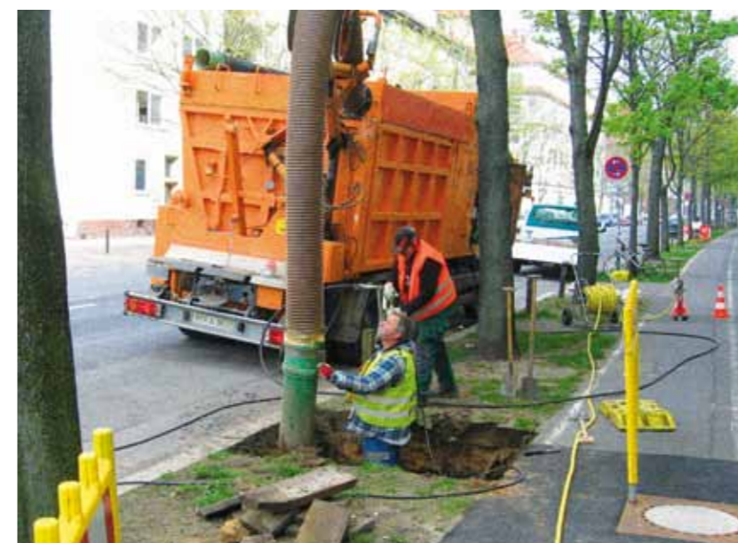
Abb. 22: Sanierung einer Baumscheibe in der Philipsbornstraße (Foto: FB Umwelt und Stadtgrün, LHH)
